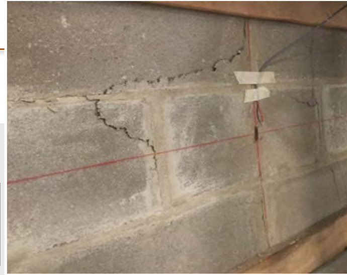
Aplastamiento de la mampostería
