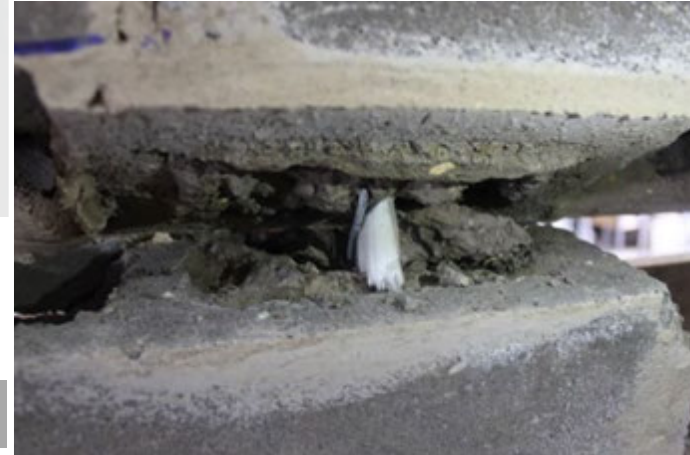
Ruptura del FRP
