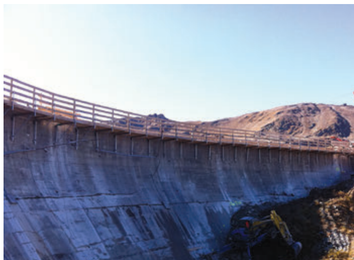
↑ Represa de Illsee, construida en 1923. Fundaciones y cresta afectadas por la reacción álcali-sílice. Rehabilitación entre 2011 y 2013.
