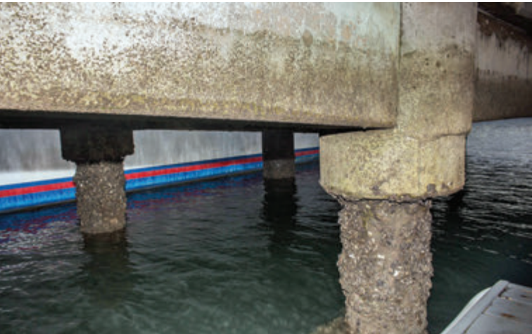
↑ Es posible notar que la mayoría de los puentes rurales y urbanos presentan condiciones patológicas críticas, que ponen en riesgo la seguridad de la comunidad. CORTESÍA CONCRETE DIAGNOSTICS
