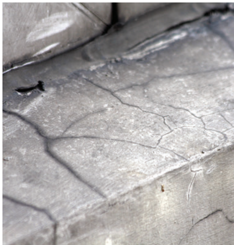
↑ El tamaño de las fisuras y el tipo de las mismas pueden determinar a que ha sido debido el daño de la estructura.
