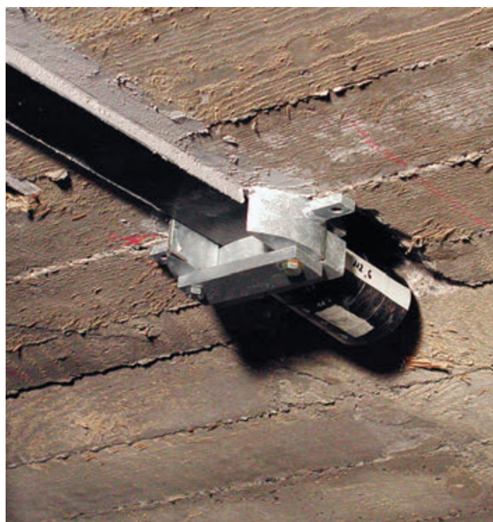
↑ Foto 1. Extremo fijo del sistema de platinas de carbono postensadas. Se ven la platina de carbono y la cabeza de fibra de carbono en su extremo, las cuales se sostienen por medio de un anclaje metálico dentro del concreto.
