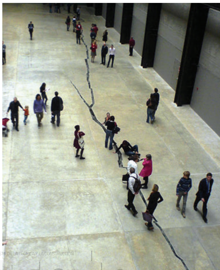
↑ Patología asociada a la cimentación. FLICKR- MATT SEPPINGS
