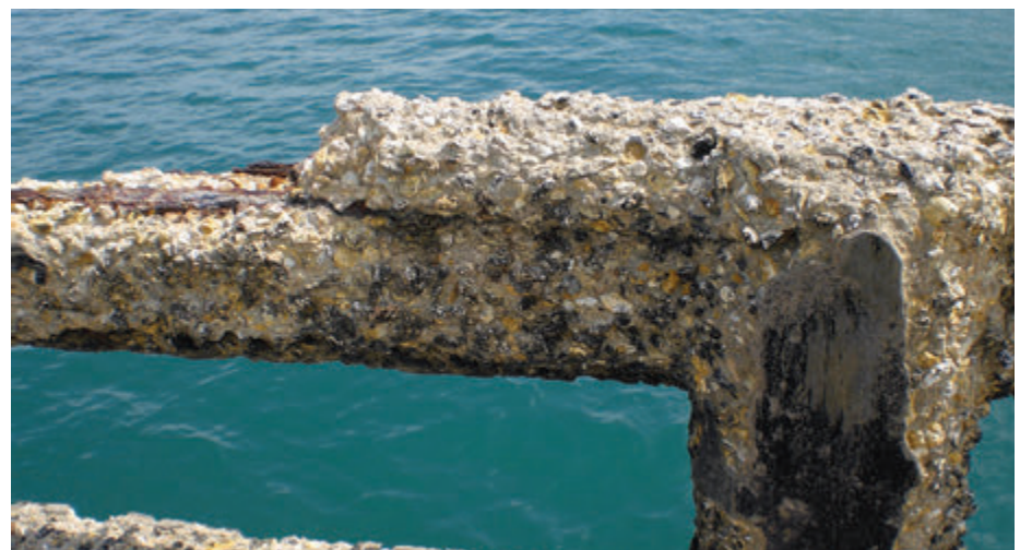
↑ Exposición directa de barras de refuerzo en barandas por falta de recubrimiento y por degradación ambiental. CORTESÍA UNIVERSIDAD DEL NORTE
