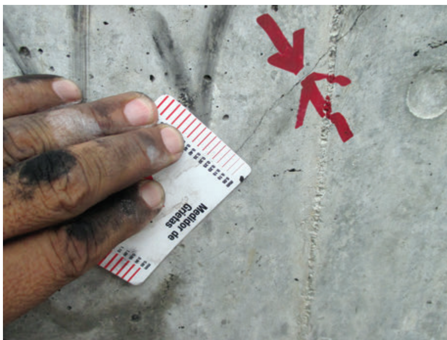
↑ Medida del espesor de fisuras, en este caso en un elemento donde, además de la conflagración, hubo un evento explosivo.
