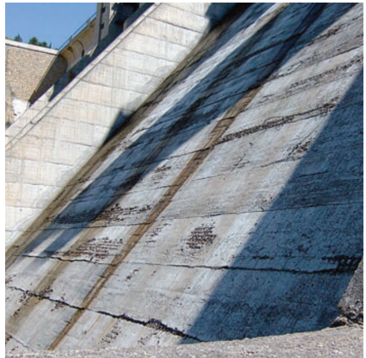
↑ Patología por ciclos de congelamiento y descongelamiento. © EDUARDO MARTÍNEZ CORREGIDOR
