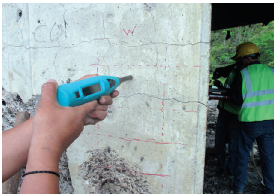
↓ Pruebas de esclerometría para delimitar zonas débiles en los elementos afectados por el fuego.
