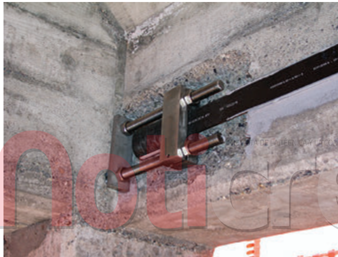
➔ Foto 9. Detalle del anclaje de la platina de carbono postensada.
