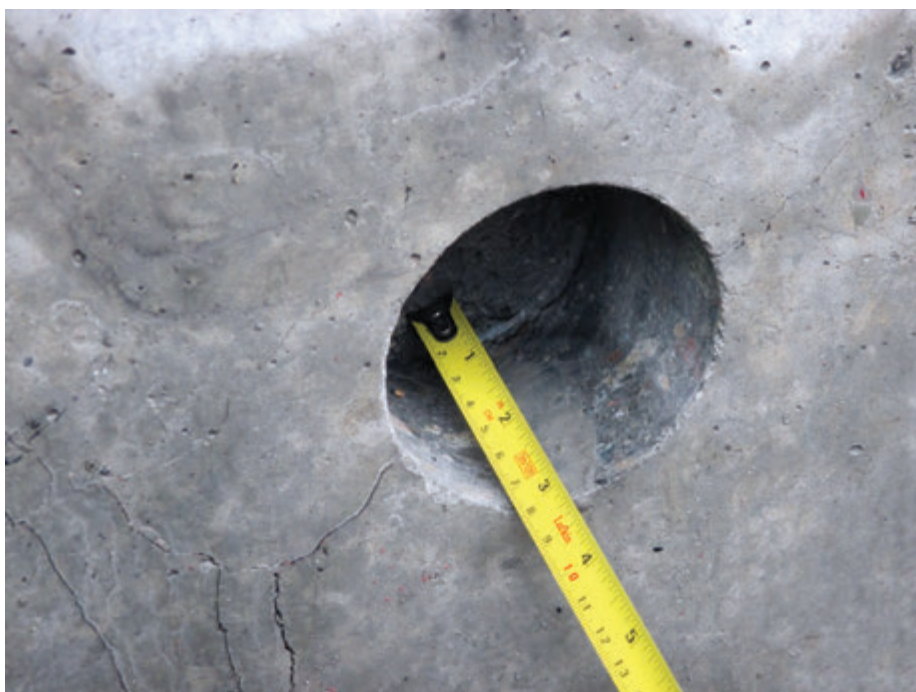
↓ Determinación de espesor fisurado mediante extracción de núcleo sobre la grieta.
