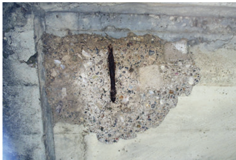
↑ El proceso de evaluación de la corrosión para las estructuras de concreto reforzadas con acero puede simplificarse en un proceso de dos etapas, la ‘fase de iniciación’ y la ‘fase de propagación’.
