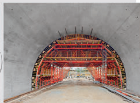
Túnel RN88 Francia
